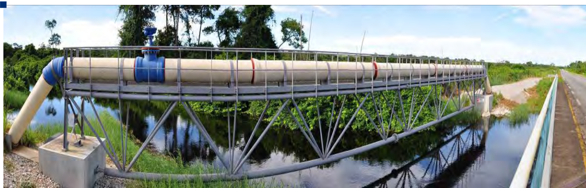
Figure 28 : Les aménagements liés à l'AEP peuvent influencer de manière permanente sur la dimension paysagère comme la conduite d'adduction d'eau de l'usine de Matiti (crique Macouria) (S.Clavier / HYDRECO)
